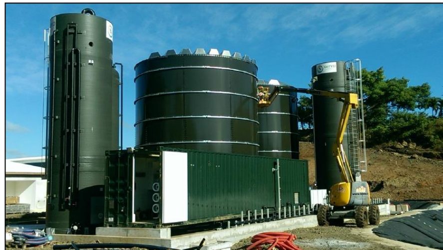
Exemple d'unité de traitements des lixiviats
